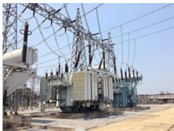
电力设备故障监测
